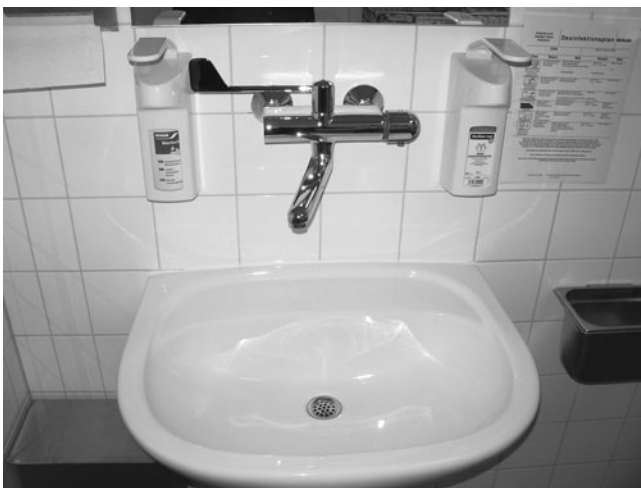
Abb. 2 ◀ Korrekt ausgestatteter Händewaschplatz
