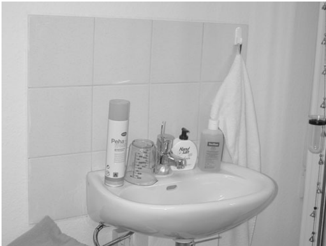
Abb. 1 ◀ Unkorrekter Händewaschplatz: Armatur nicht handberührungsfrei zu bedienen, Überlauf am Waschbecken, Wasserstrahl direkt in den Abfluss gerichtet, fehlende Spender für Seife, Händedesinfektionsmittel und Handtücher
